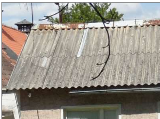
Fot.1 Płyty azbestowo-cementowe faliste
