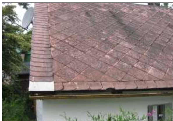
Fot. 2 Płyty azbestowo-cementowe płaskie
