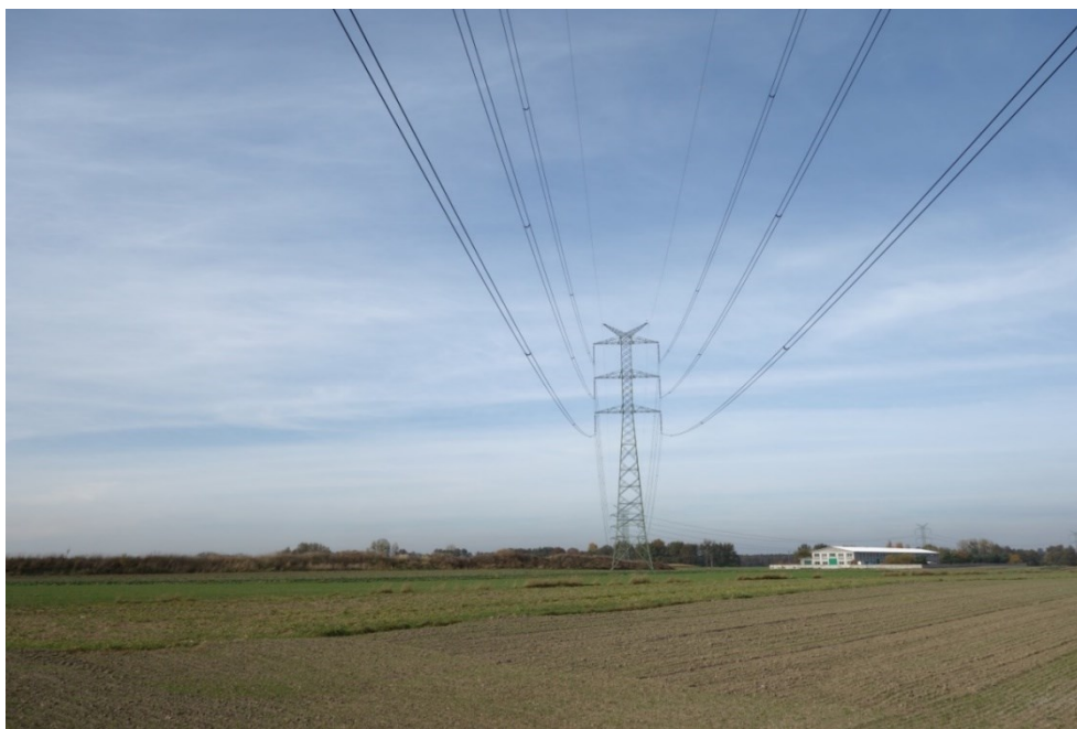
Ryc. 11 Dwutorowa linia elektroenergetyczna wysokiego napięcia 400 kV
