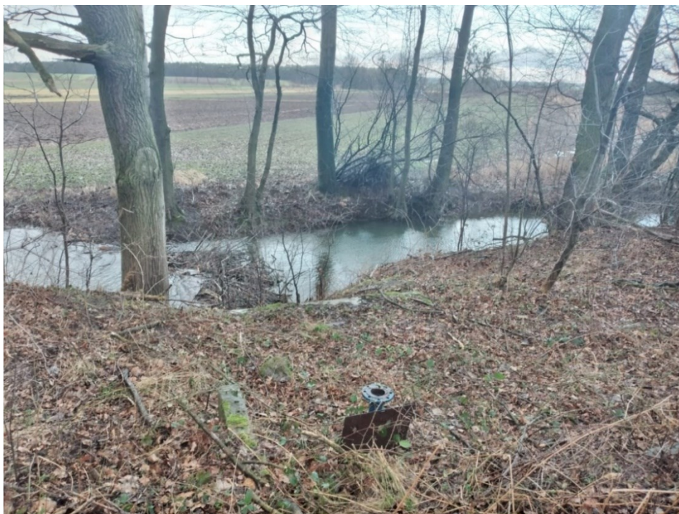
Ryc. 9 Pompownia wody technologicznej (ujęcie powierzchniowe z rzeki Młynówki)
